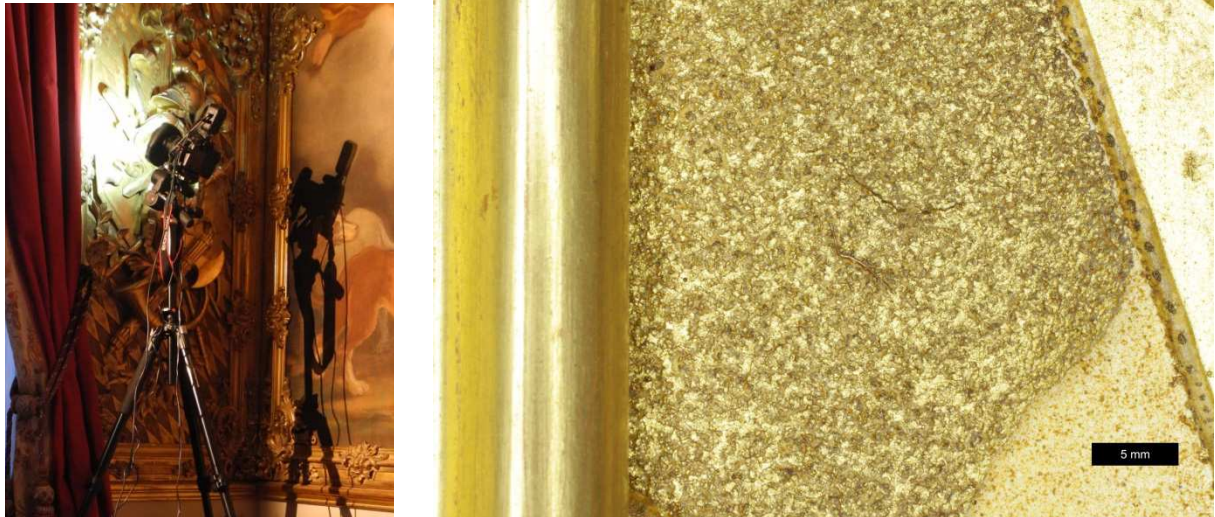
Abbildung 3: Links: Untersuchung mit hochauflösender Fotografie Übersicht der Position im Östlichen Gobelzimmer an vergoldeter Sandelung, rechts: Detailaufnahme der Monitoring Position an einer gelockerten Fassungsscholle, © Bayerische Schlösserverwaltung.
